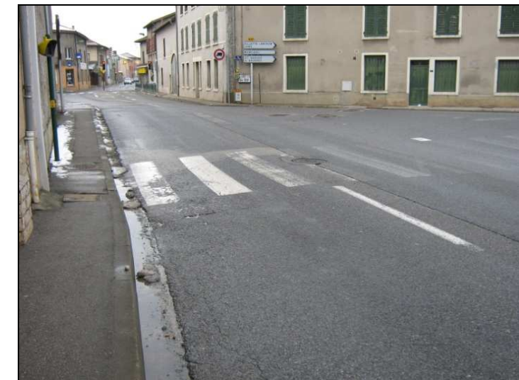
Pusignan – RD 302 : Trottoir trop étroit, et absence de bateau et de bande podotactile au niveau du passage piéton.
